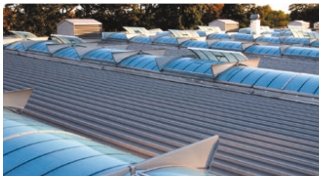
Gewölbtes Lichtband mit RWA-Doppelklappen und Windleitwänden
