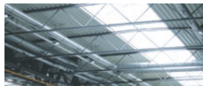
JET-VARIO-NORM-Lichtband mit Tageslicht, optimale Raumausleuchtung und Energiekosten-einsparung
