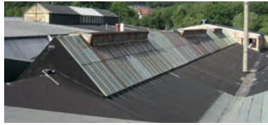
Drótüveges sávós felülvilágító felújítás előtt
